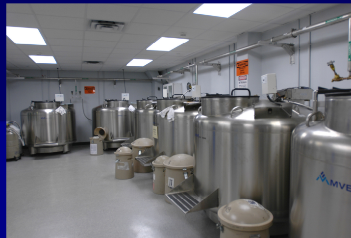
液態氮儲存庫全景
