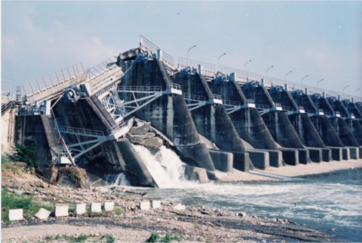
圖 03：原台中縣石岡鄉石岡大壩在九二一地震中嚴重損毀。《用心看石岡，真的不一樣！》 照片集，吳國禎，創作日期不詳，數位島嶼。
