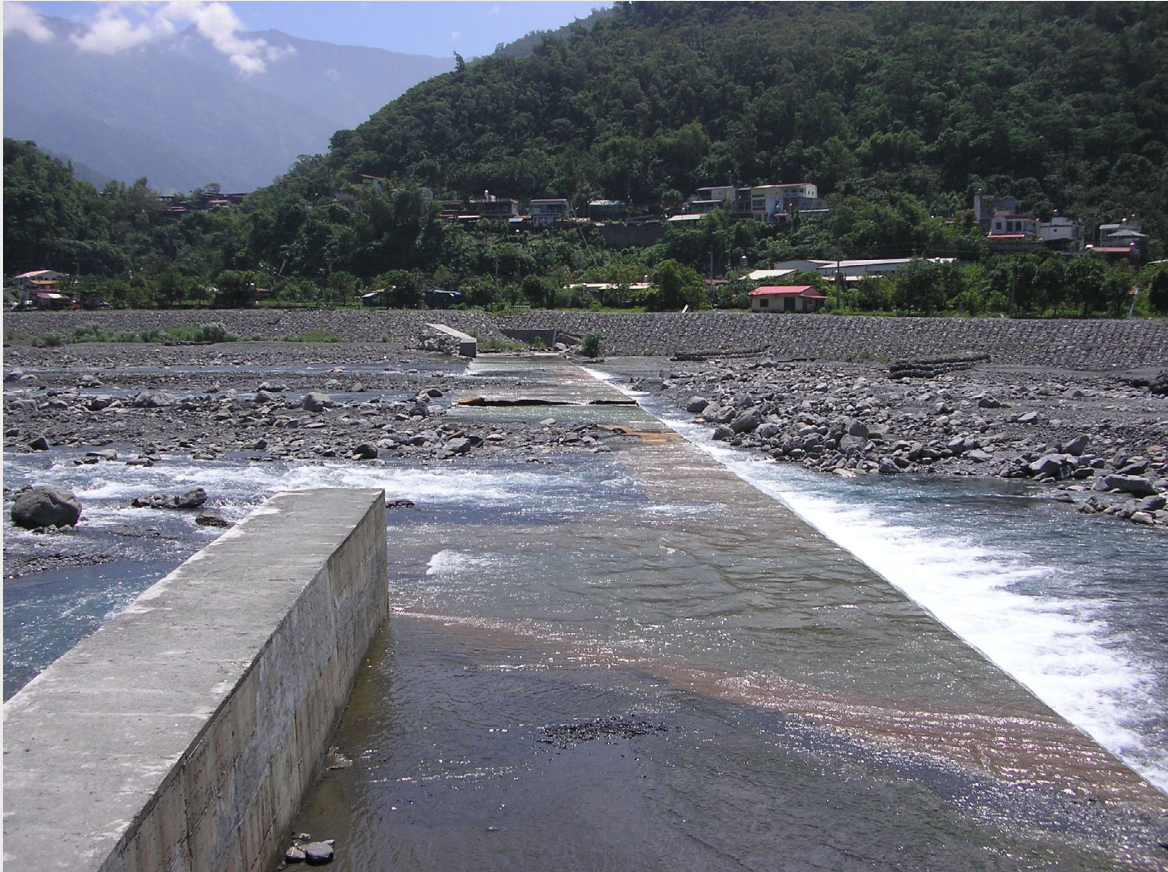
圖 04：近年由於河水沖刷，橫跨河床的攔水梯形結構物已經出露，需要整修保護。〈二峰圳〉，汪中和攝，攝影年份：2008。圖片提供者：汪中和。網站名稱：數位島嶼。
