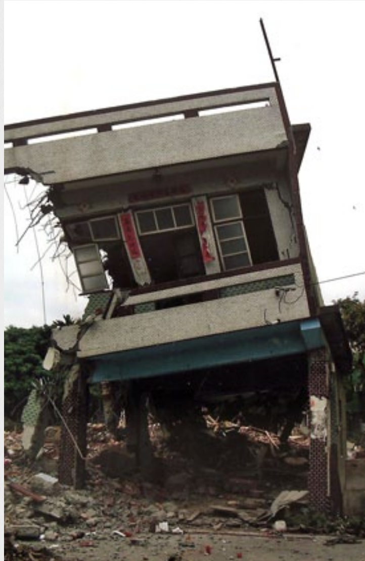
圖 02：1999 年 9 月 21 日發生芮氏規模 7.3 的集集大地震，上萬棟房屋倒塌，圖中位於南投縣的一間房舍左半部化為一堆碎瓦礫。〈921大地震〉，奇哥，創作日期不詳，數位島嶼。
