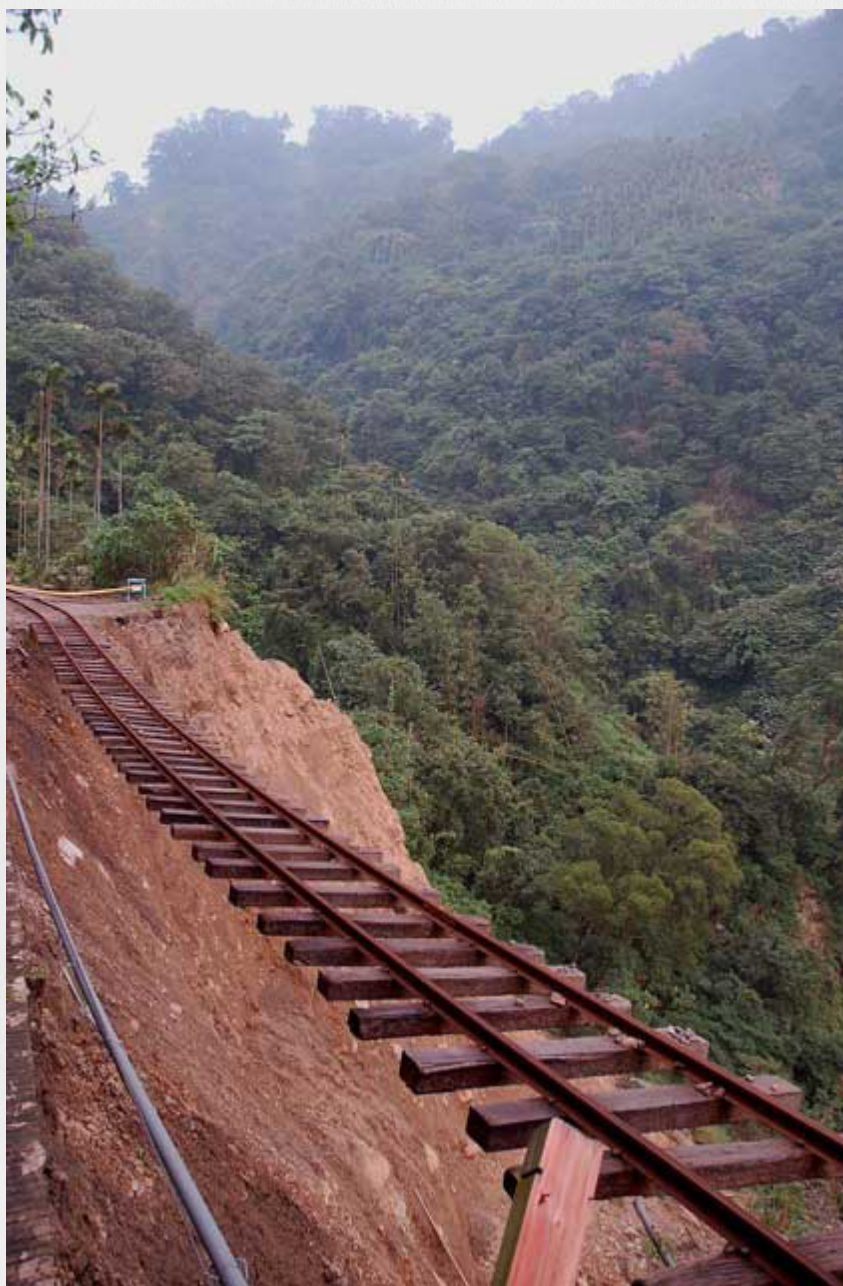
圖 11：〈23K崩塌現場〉，蘇昭旭攝，年份：2008。圖片提供者：蘇昭旭。網站名稱：蘇昭旭老師的全球鐵道視野部落格。
